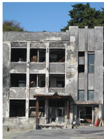
火災にあった小学校
